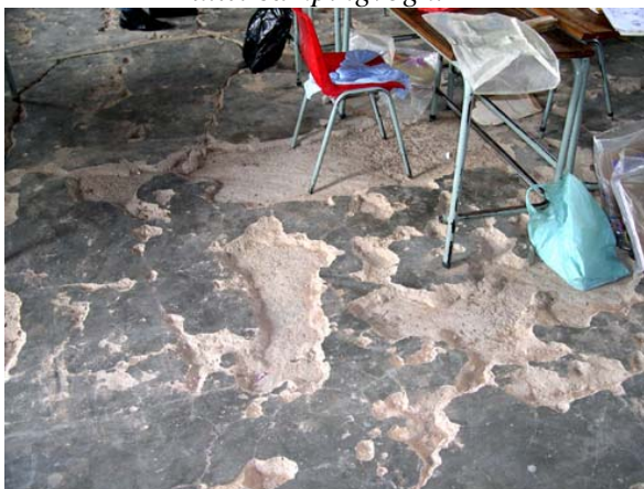
Sådan så det ødelagte skolegulv ud i et af undervisningslokalerne
