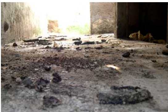
Men toiletterne! Øverste ses bygningen udefra Nederste ses afføring på gulvet inde, fordi selve toilettet er for ulækkert at bruge
