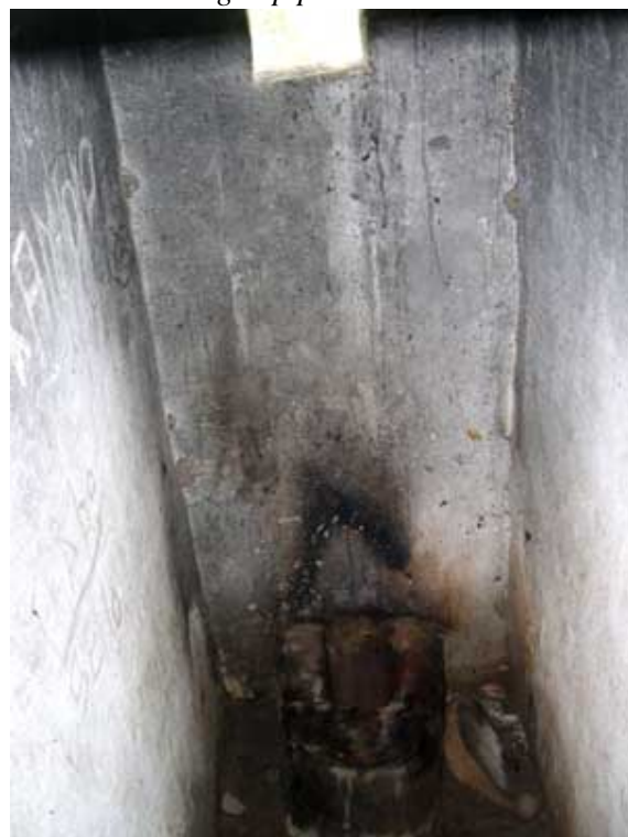
Billede af et af de 3 toiletter. De var alle ens. Vi har aldrig set så uhygiejniske og dårlige toiletforhold.
